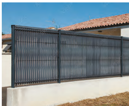
Muret + panneaux PVC, une surélévation peu esthétique
