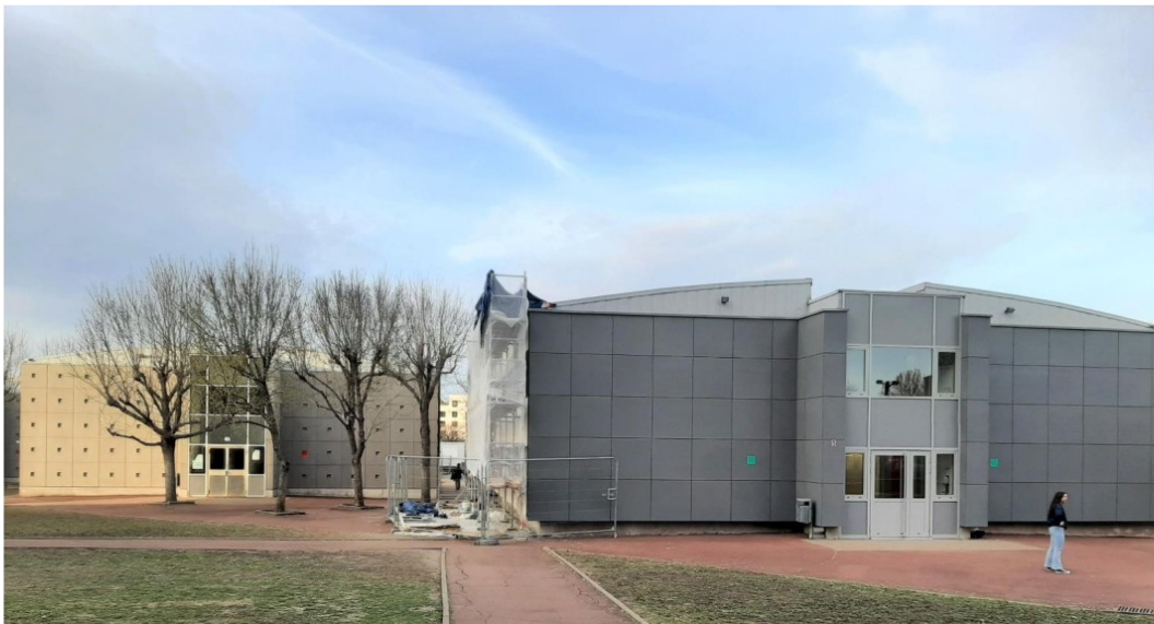
Internat du lycée La Fayette à Clermont-Ferrand / Région Auvergne-Rhône-Alpes Objectif de réduction des consommations énergétiques de 15% sur l'ensemble du site y compris les ateliers, l'imprimerie et la demi-pension (hors périmètre travaux)
