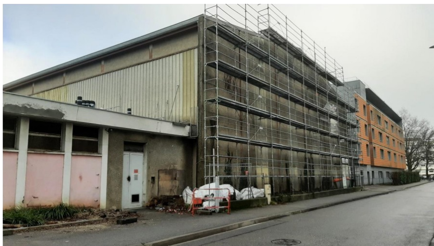
Gymnase Léon Jouhaux à Grenoble Objectif de réduction des consommations énergétiques de 35% - Hors part de l'installation photovoltaïque
