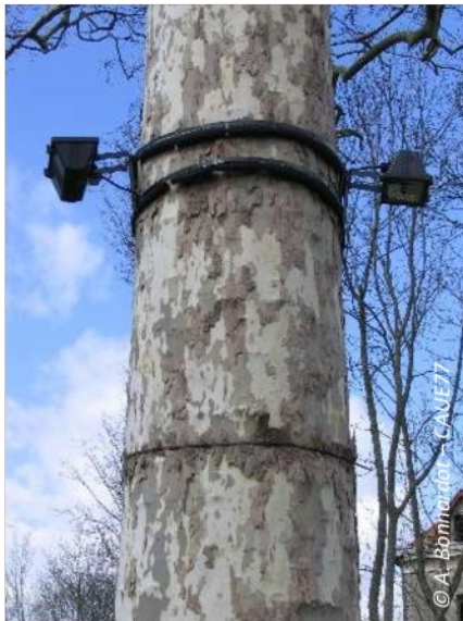
Équipement électrique sur platane générant un risque de strangulation.
