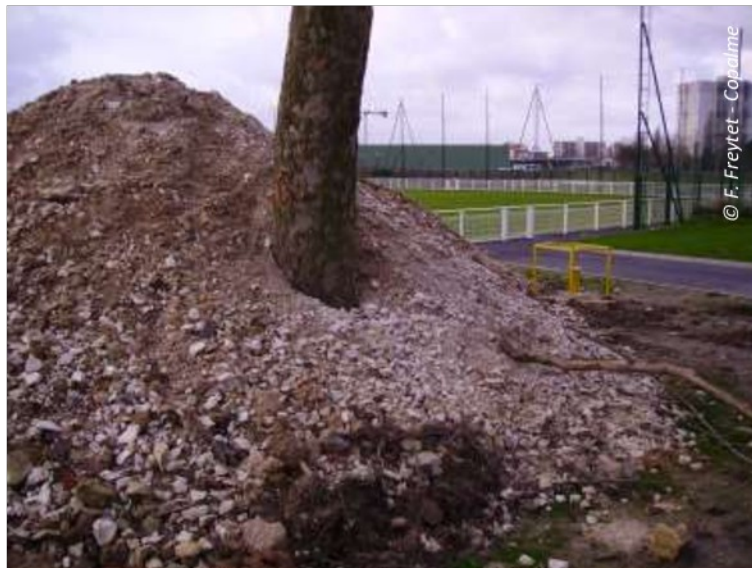
Dépôt de matériaux au pied d'un platane pendant des travaux.
